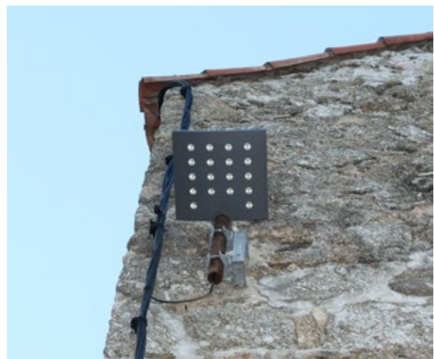
Image d'un lampadaire à LED de la commune de Mandagout dans le Gard, photo Dominique Carrière.
