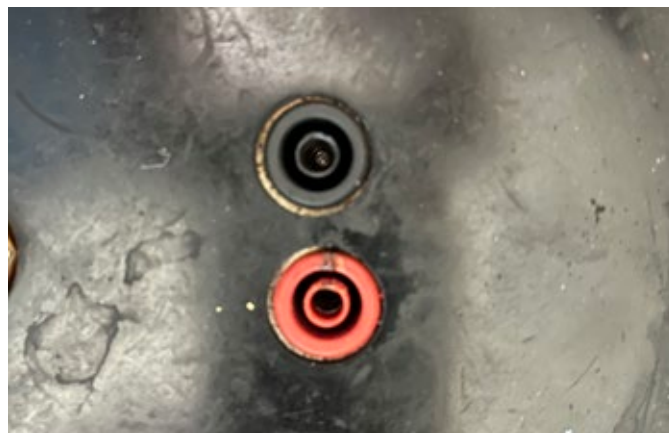
Fig.5. Le plastique des bornes électriques présentes sur le plateau d'origine a fondu à cause de décharges observées entre la base des fils électriques et le métal du plateau. Crédit A Durieux.
